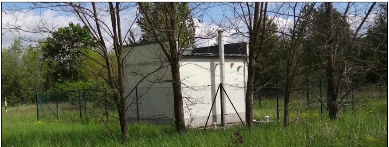
Abbildung 15: Abwasserpumpwerk an der geplanten Straße
